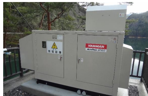
完成した予備発電設備
