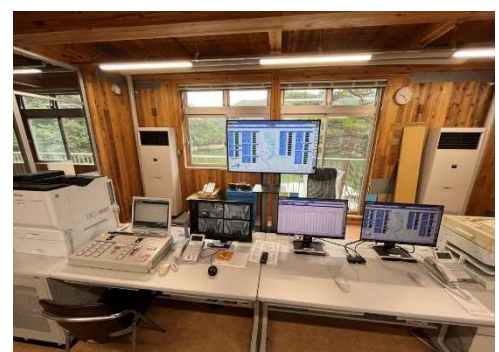
完成した水管理システム
