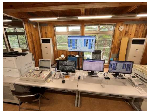
完成した水管理システム
